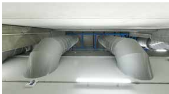
Dutos em polipropileno
