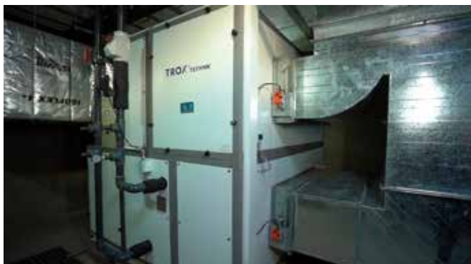
Unidades de tratamento do ar em casas de máquinas subterrâneas
