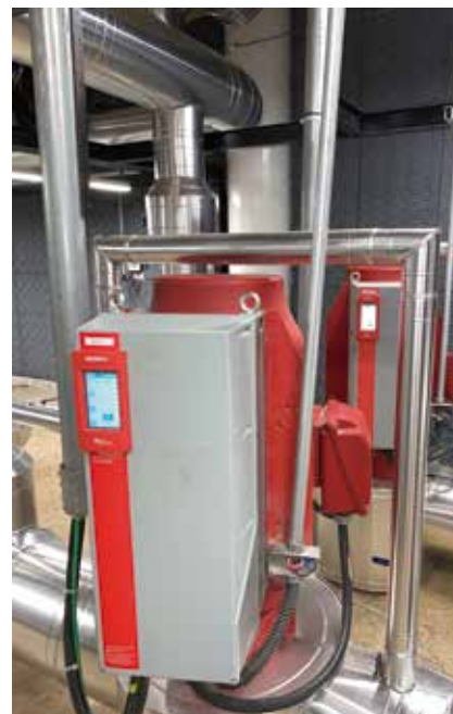
Sistema de bombeamento
