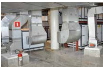
Dutos em painéis pré-isolados
