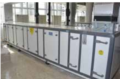
Unidades de tratamento de ar
