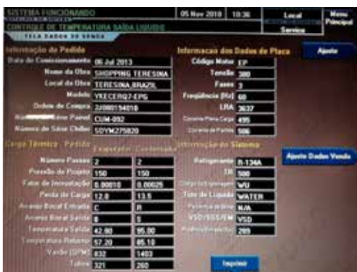
Figura 1. Tela de dados dos chillers de 500 TR
