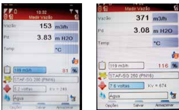
Figuras 3 (a e b). Medições de vazão de água gelada (a) e de condensação (b) no chiller de 500 TR
