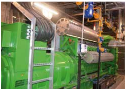
Gerador a gás Jenbacher
